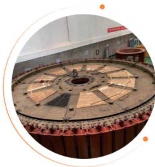
水輪機 Hydraulic Turbine
